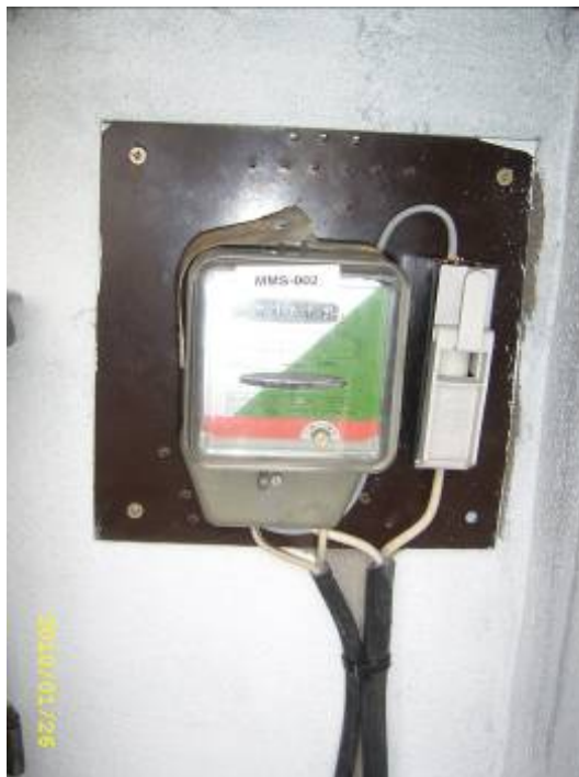
Detalle de la instalación
